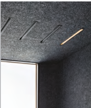
Leistungsfähiges Ventilationssystem und Beleuchtung
